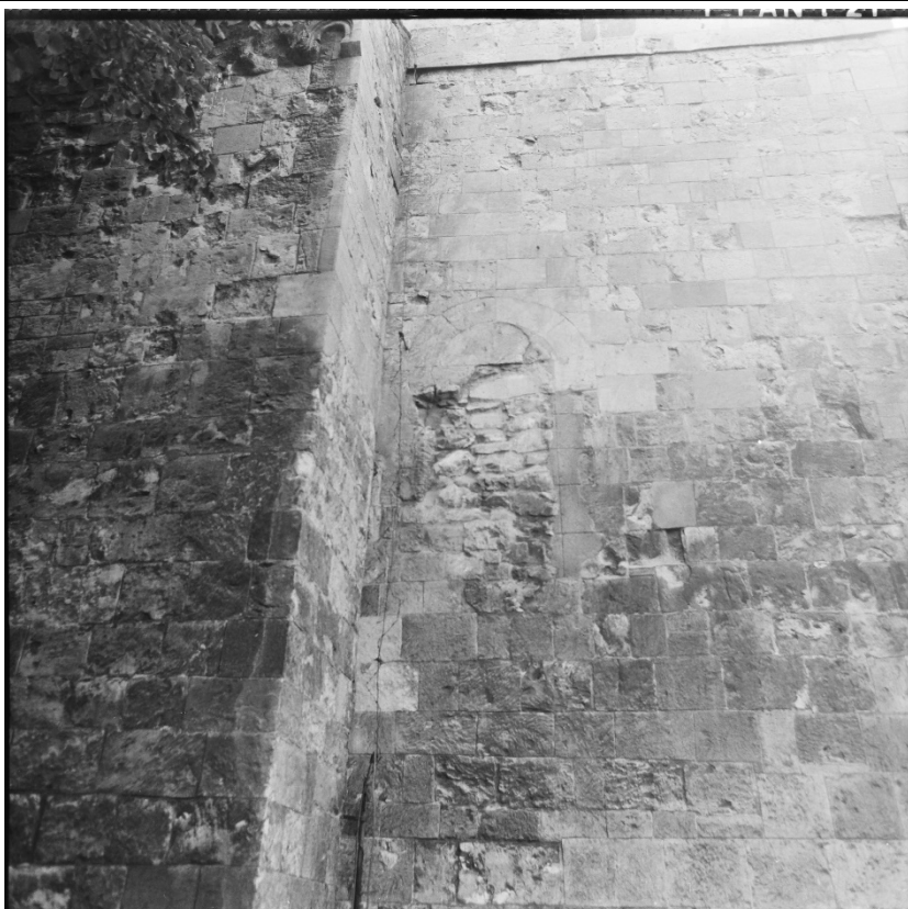
Detail zazděného portálu do 1. patra věže na jejím severním průčelí. Foto: 1983, sbírka negativů NPÚ ÚOP v Ústí n. L., sign. 71071.
