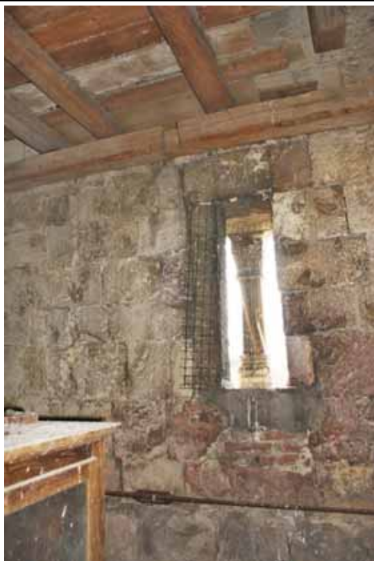
Sdružený okenní otvor jižní zdi druhého patra věže v pohledu od severu. Foto: Lucie Radová, 2009.
