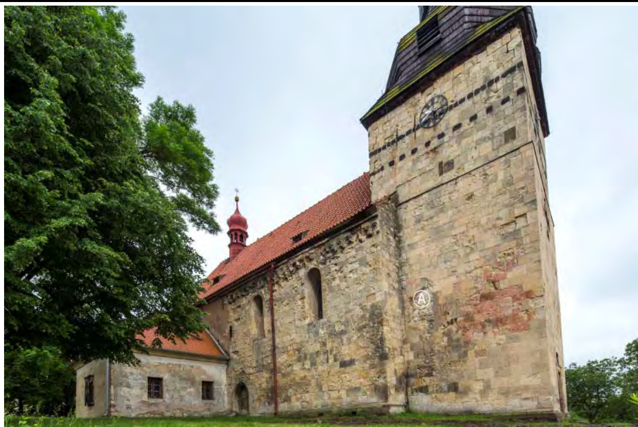
Pohled od severozápadu. A – poloha zadržného románského portálu do prvního patra věže. Foto: Marta Pavlíková, 2014.
