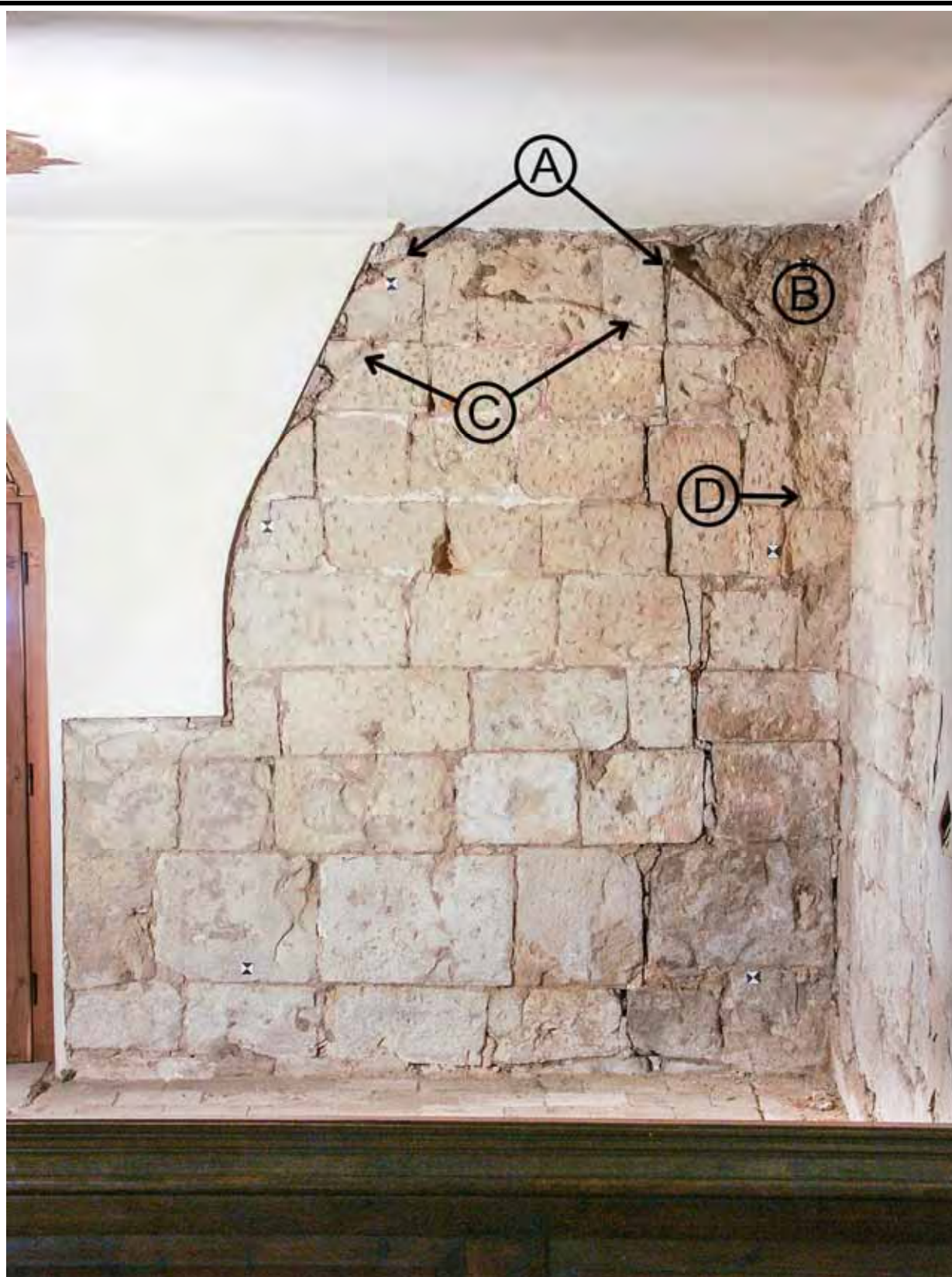
Čelní pohled od východu na odhalený líc západní stěny lodi při jejím severozápadním koutě. Foto: Jaroslav Skopec, 2009. A) Hrany čelního oblouku klenby. B) Jizva po odstraněném zdivu klenební kápě. C) Dodatečná drážka připravená patrně k mladšímu překlenutí tribuny. D) Jizva po odstraněném koutovém klenebním výběhu.
