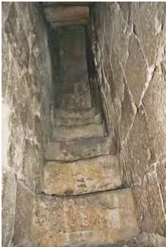
Horní rameno schodiště v tloušťce zdi mezi prvním a druhým patrem věže v pohledu od severu. Foto: Lucie Radová, 2009.
